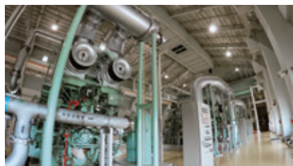
図5 撮影場所：巨椋池排水機場の内部 (撮影：櫻井 宏哉)
