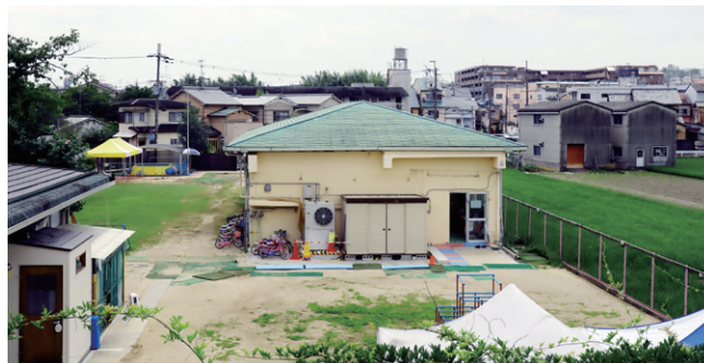
成安幼稚園遊戯棟等建替事業(写真 | 解体撤去中の遊戯棟と撤去後の様子)
